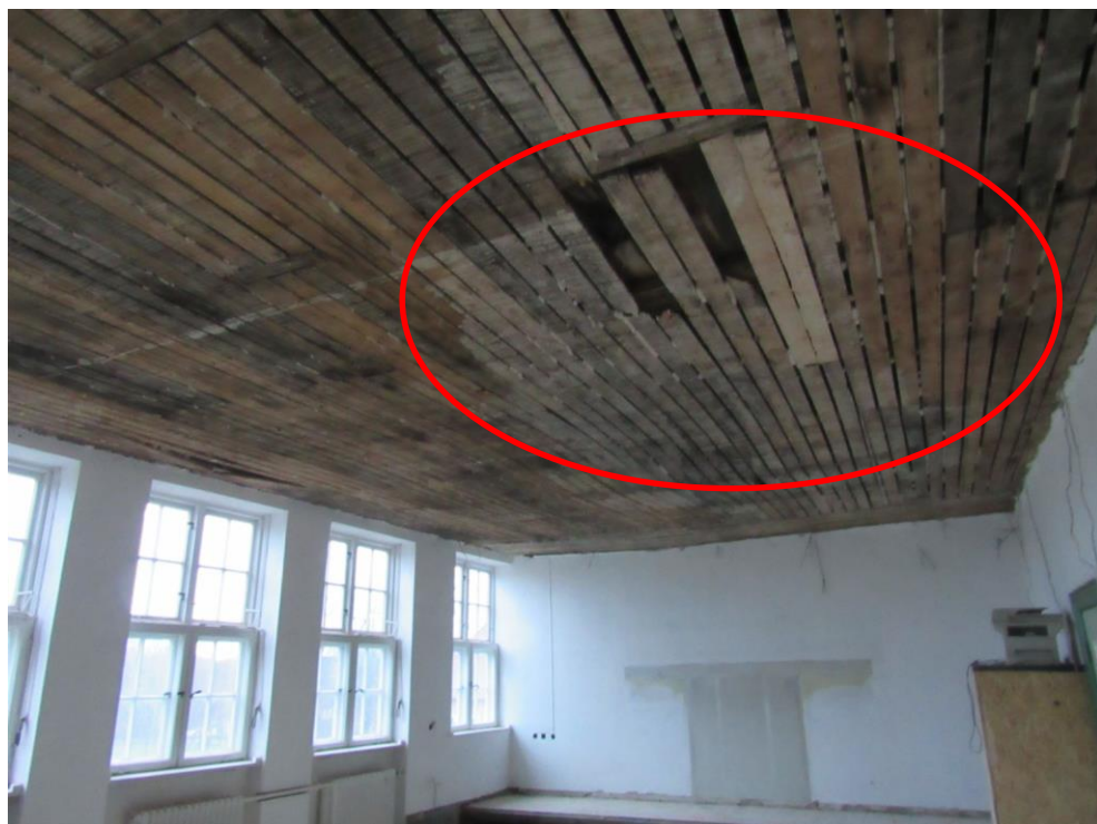
Decke über Raum DG-02 mit starkem Durchhang der Balkenlage, besonders unter einer Stütze.
