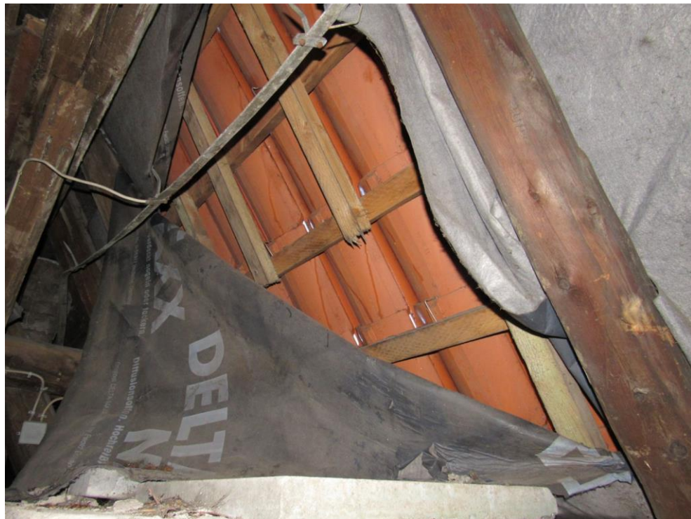
Beispielhafte Leckage Bereiche der Dacheindeckung, besonders im Altbereich mit vermörtelten Dachziegeln.
