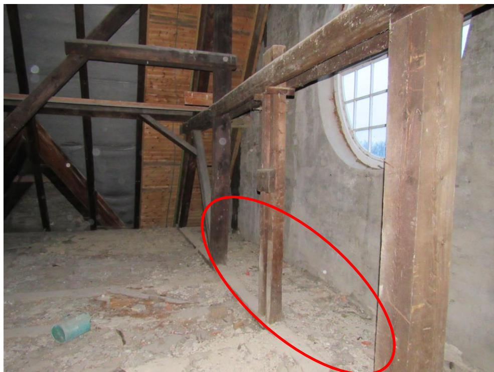
Balkenköpfe im Mauerauflagerbereich Nord Giebel zeigten bei Bohrwiderstandsuntersuchungen Schädigungen durch Fäulnispilze. Hier empfiehlt sich eine Kontrolle durch Freilegung.
