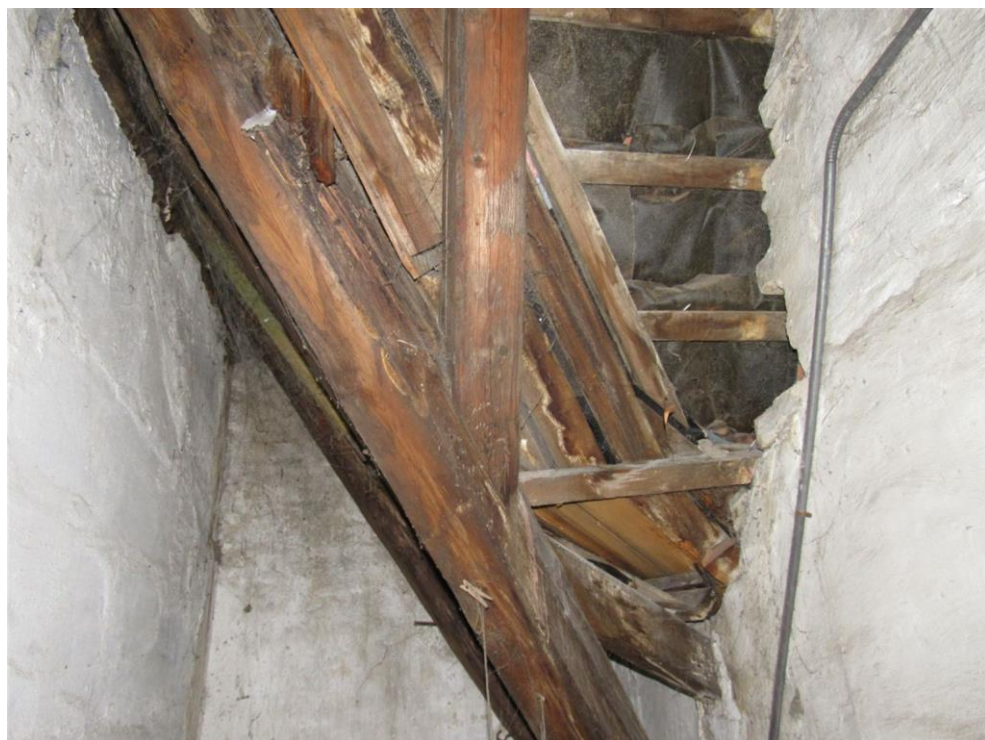
Beispielhaft: Schädigungen in Kehlbereichen durch Fäulnis aufgrund von Durchfeuchtungen.
