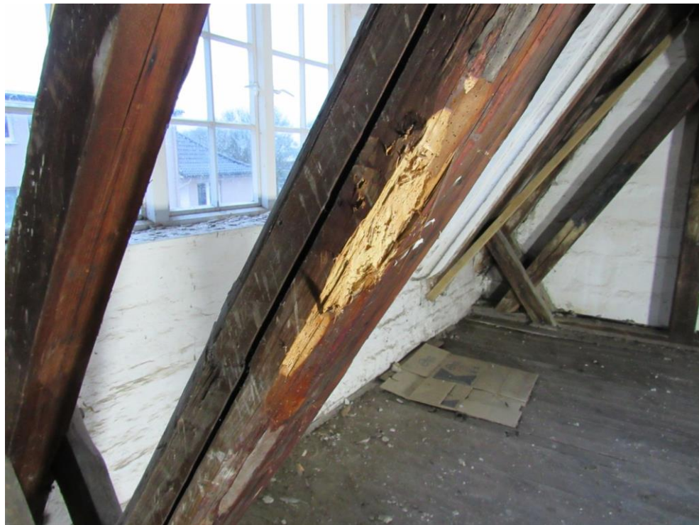
Insektenbefall bei zahlreichen Hölzern der Dachkonstruktion (hier abgebeilte Stelle als Beispiel)
