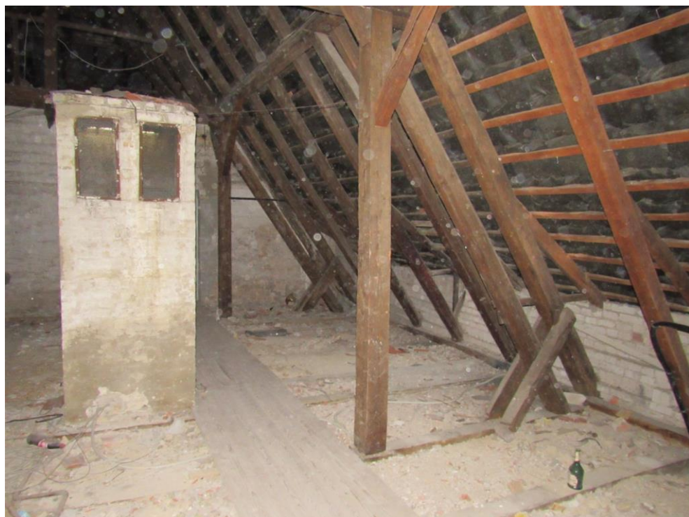
Dachbereich Dachraum DG-05, Altbau, Empfehlung: Balkenauflager Außenwände freilegen und prüfen.
