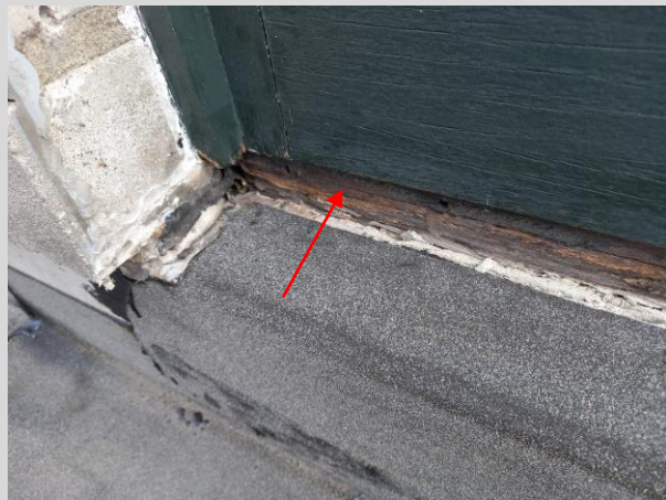
teilweise marodes Einstandsprofil
