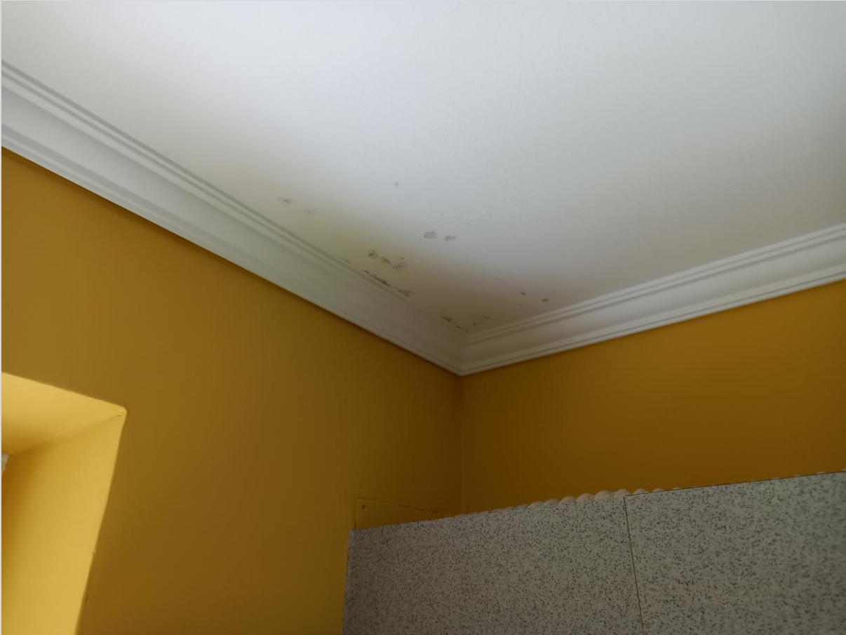
Schimmelbildung an der Küchendecke
