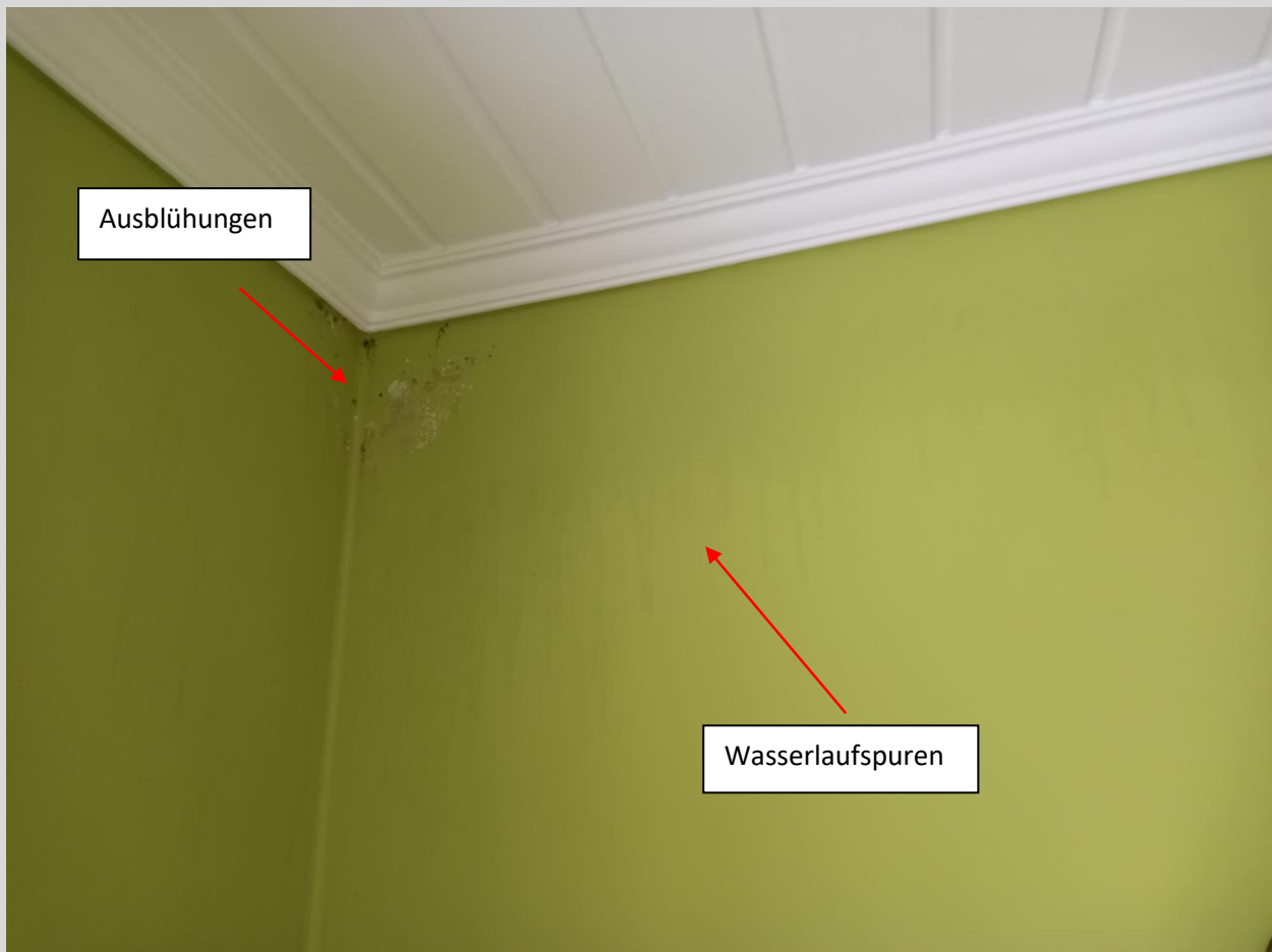
Ausblühungen in der Gebäudeecke, Wasserlaufspuren an der Wand
