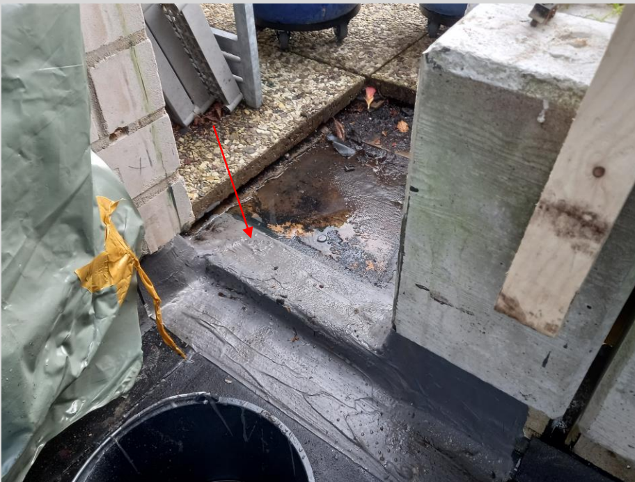
Der Übergang zur Nachbarterrasse wurde abgesperrt
