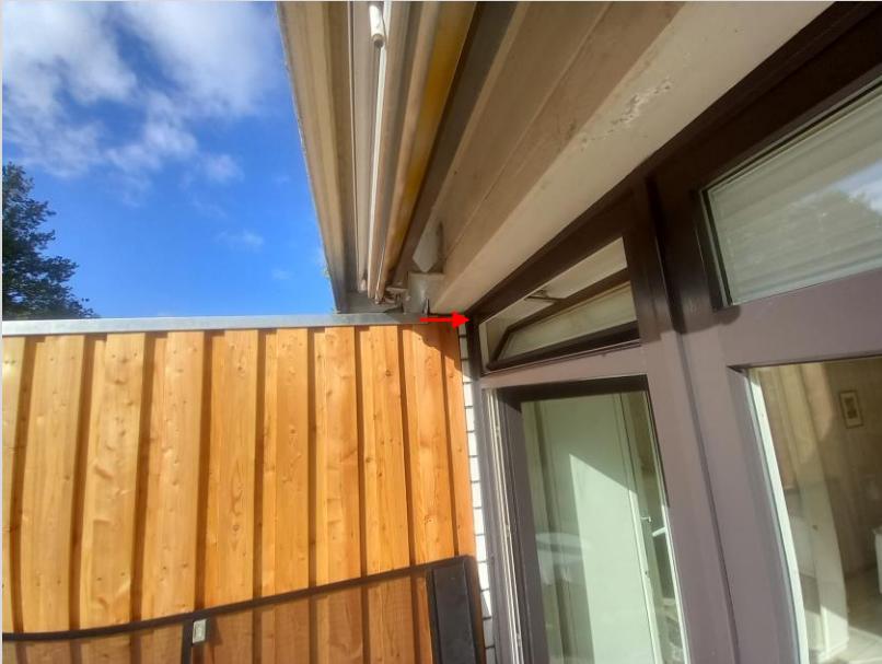
Die Windfeder ist zu verlängern, die Gase-Tür ist einzubauen
