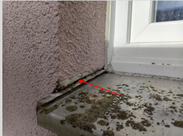
Vorh. mangelhafte Sohlbankanschlüsse
