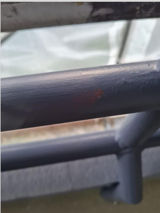
Geländer sind nachzuarbeiten
