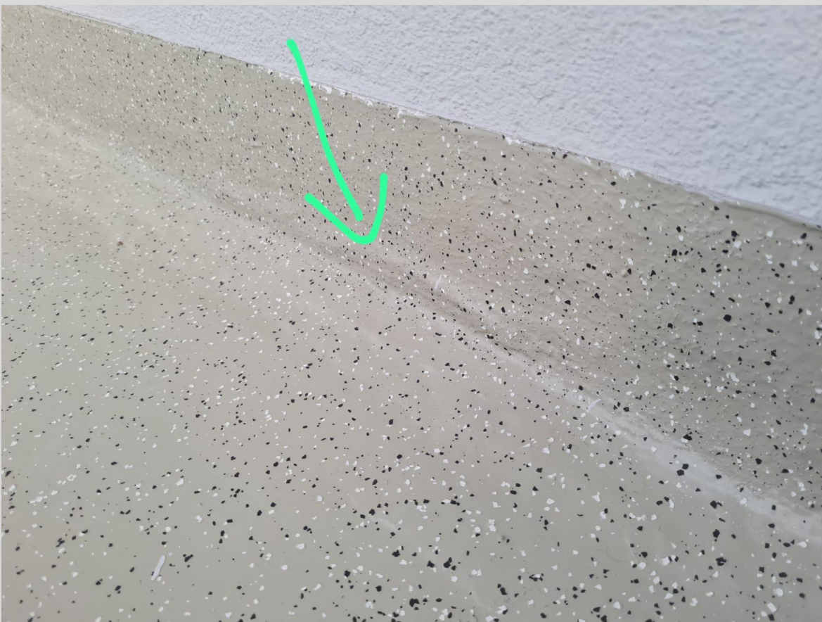
Hohlstellen in der Randabdichtung
