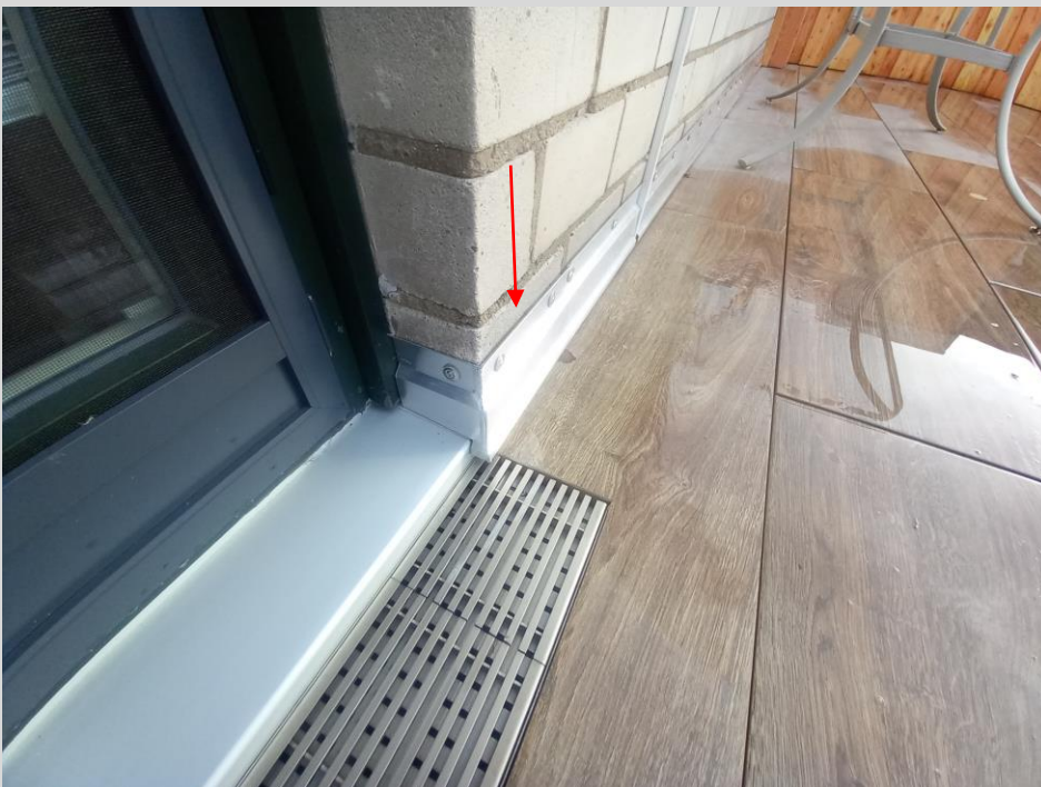
Das Trittschutzprofil an der Außenfassade wird nicht versiegelt
