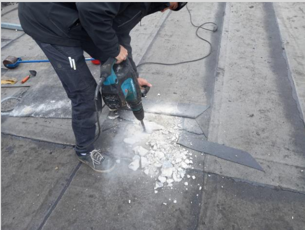
Rissbereich wird geöffnet
