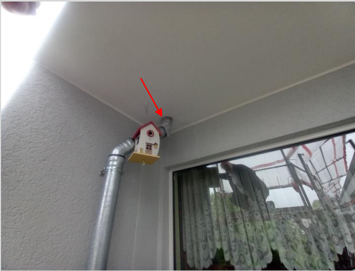
Undichtigkeit am Anschlusspunkt RW
