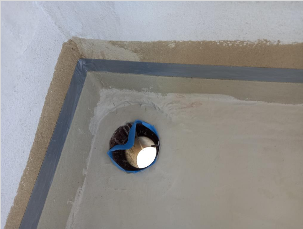
Bemängelte Kante um die neuen Bodeneinläufe
