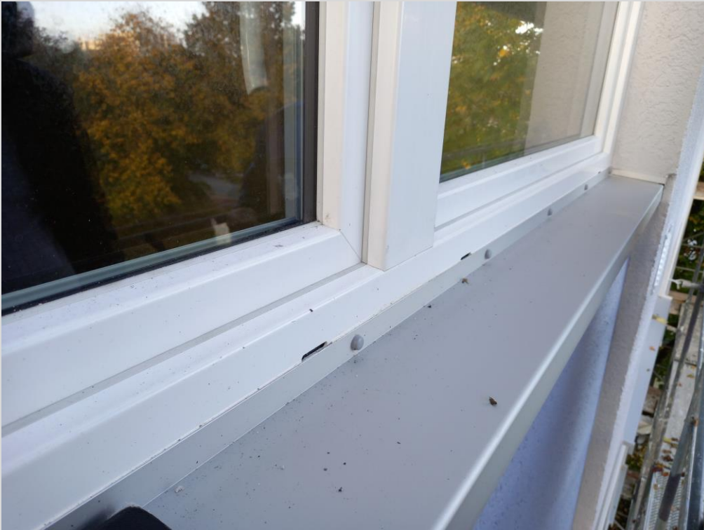
Öffnungen der Fensterrahmen müssen frei liegen
