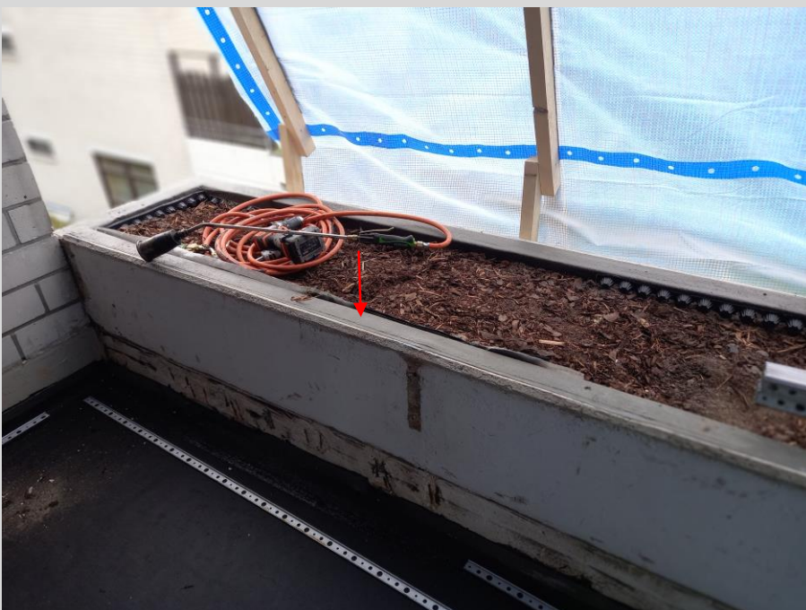
Die Zinkabdeckung auf den Trögen fehlen noch
