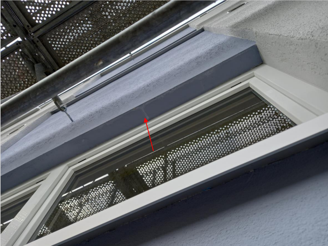
Das Wasser kann an der Tropfkante nicht richtig abreißen, Wasserspuren sind sichtbar
