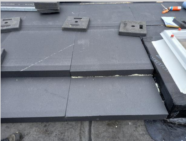
Platten sind hier nicht im Verband verlegt
