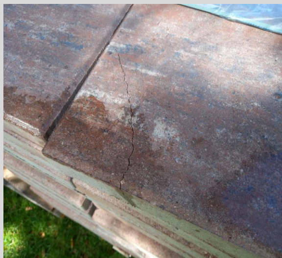
Defekte Platten entdeckt
