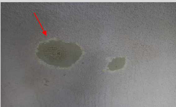
Beschädigungen wurden geschliffen und grundiert
