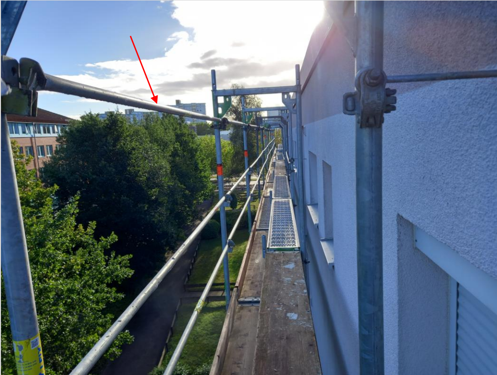
Die fehlende Absturzsicherung wurde nachgerüstet
