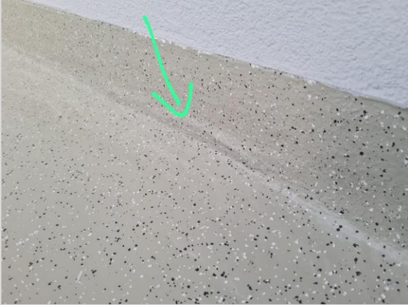
Wandanschluss nicht hinterfüllt
