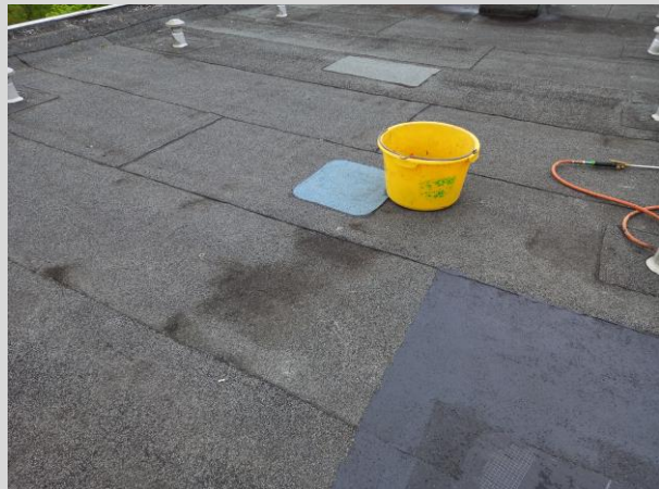
Probeöffnungen zur Lokalisierung des Schadenumfanges, verschlossen
