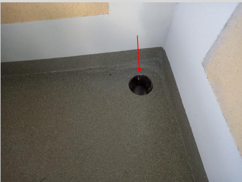
Bodeneinlauf steht zu hoch
