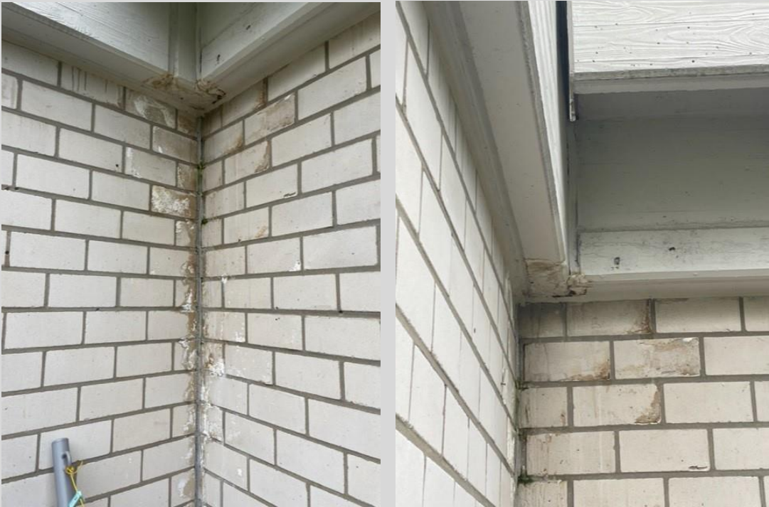
Regenwasser drückt durch die unsanierten Pflanztröge nach außen
