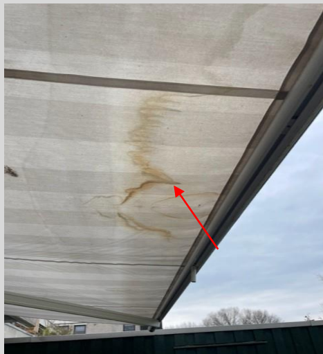
Wasserflecken auf der Markise
