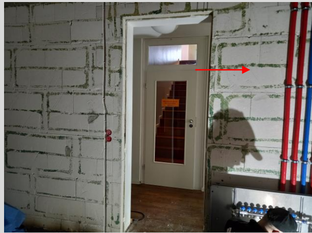
Unterverteilung über Heizkreisverteiler
