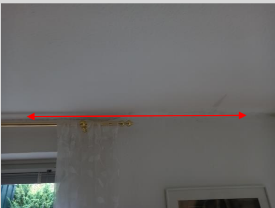
Feuchtigkeit im Deckenbereich
