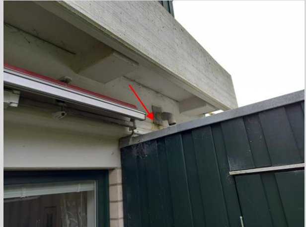
Wasser tritt aus der Rohrdurchführung aus
