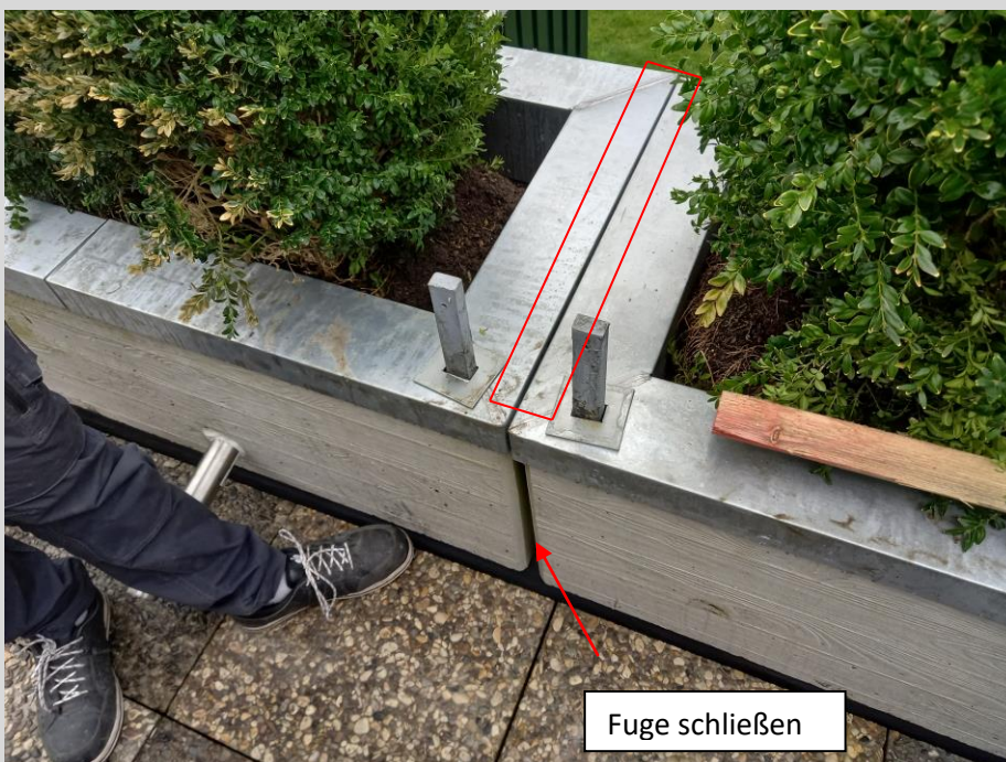
Die Stöße der Pflanztröge sollen überdeckt werden
