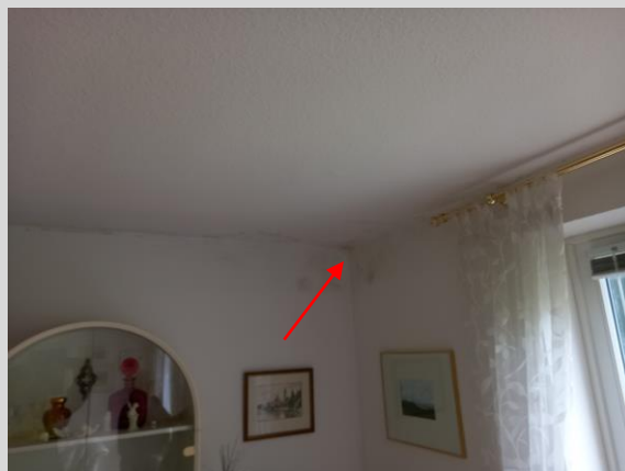
Feuchtigkeit in der Gebäudeecke
