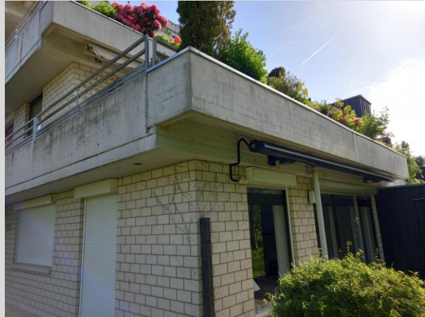
Ausblühungen an den Stoßfugen der Tröge
