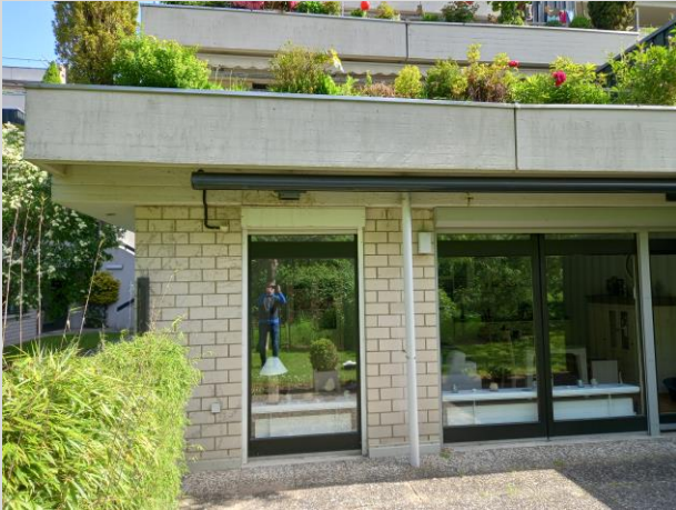
Wasserlauspuren im Sturzbereich
