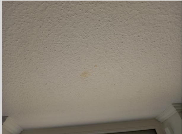
Verfärbung an der Wohnzimmerdecke
