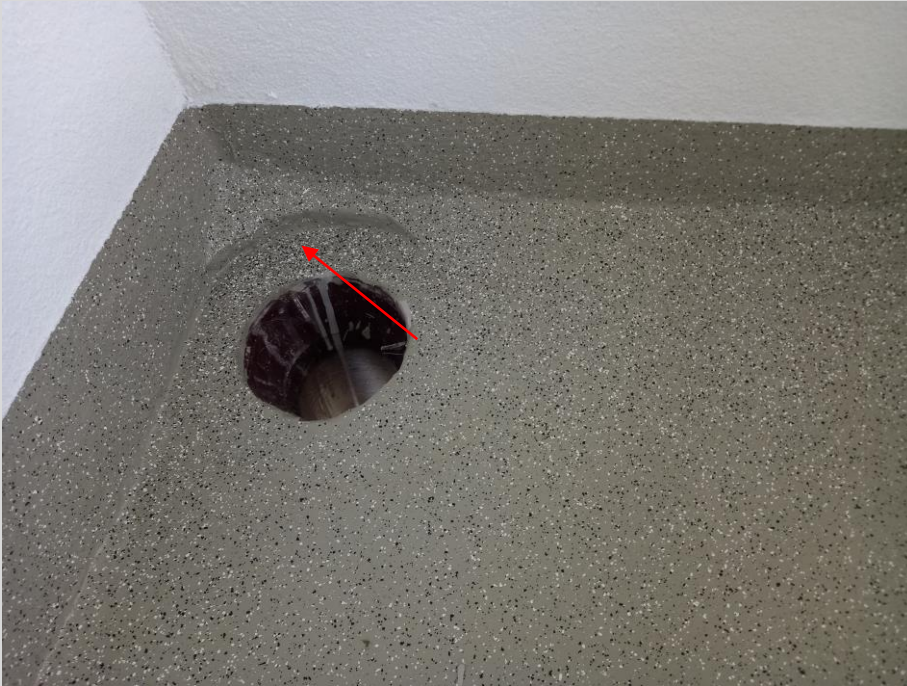
Kante um den Bodeneinlauf
