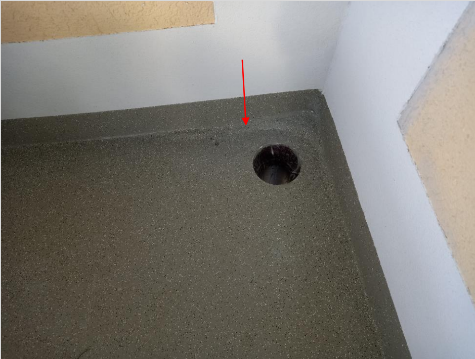
Bodeneinlauf hier noch zu hoch
