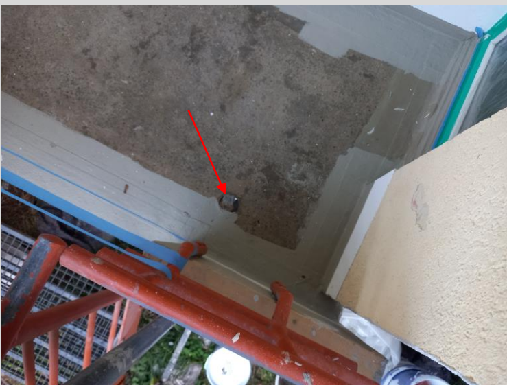
Der alte Stützenfuß ist plan zu schleifen/spachteln
