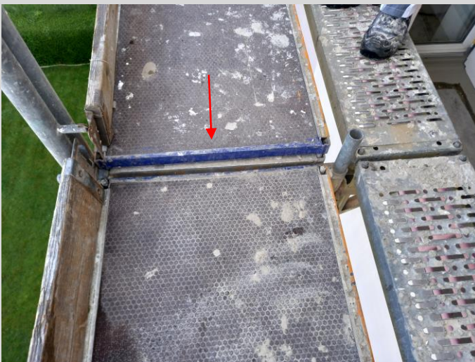
Gerüstbohle wurde auf defekte Bohle aufgelegt/Stolpergefahr
