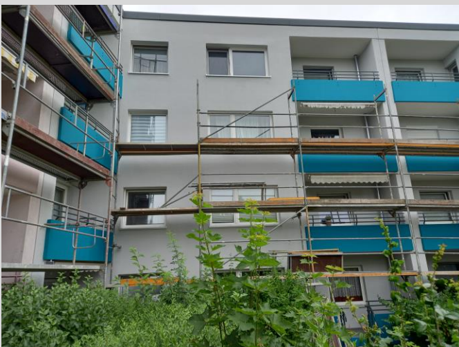
offene ungesicherte Gerüstlagen
