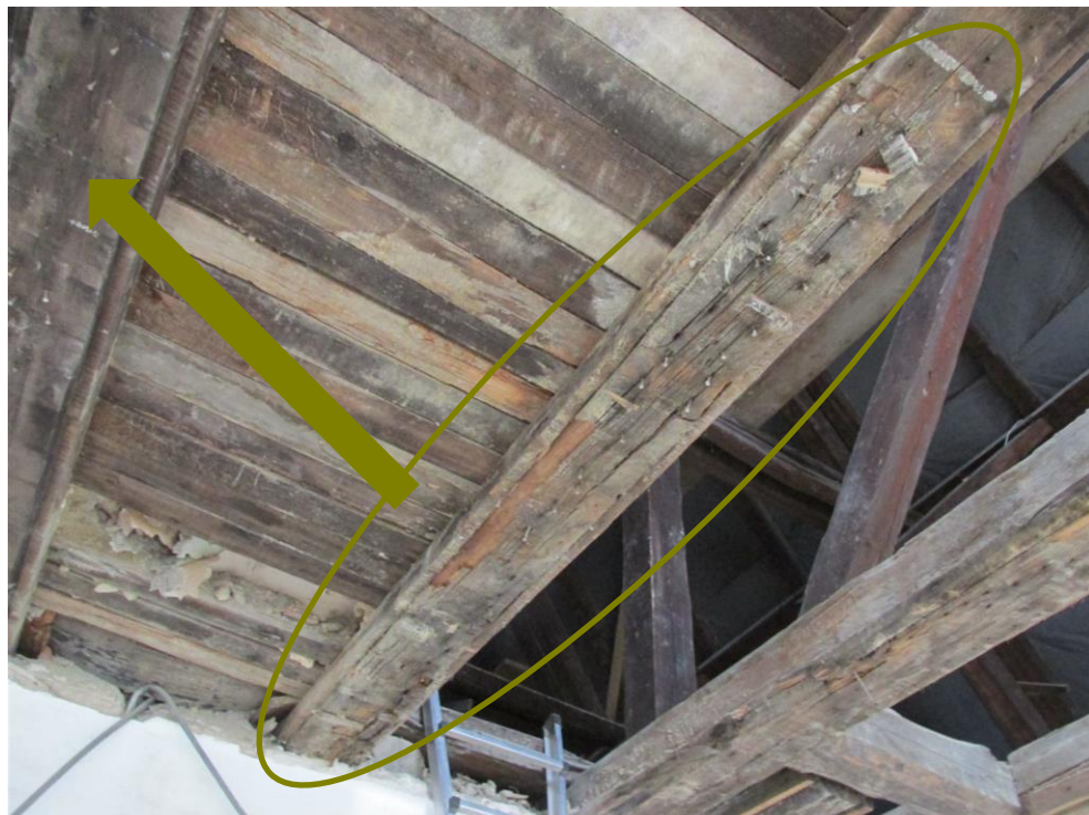
Balken 5 starke Braunfäule (weißer Porenschwamm), Einschätzung: abgängig. Balken 6, starke Braunfäule, Einschätzung: abgängig.
