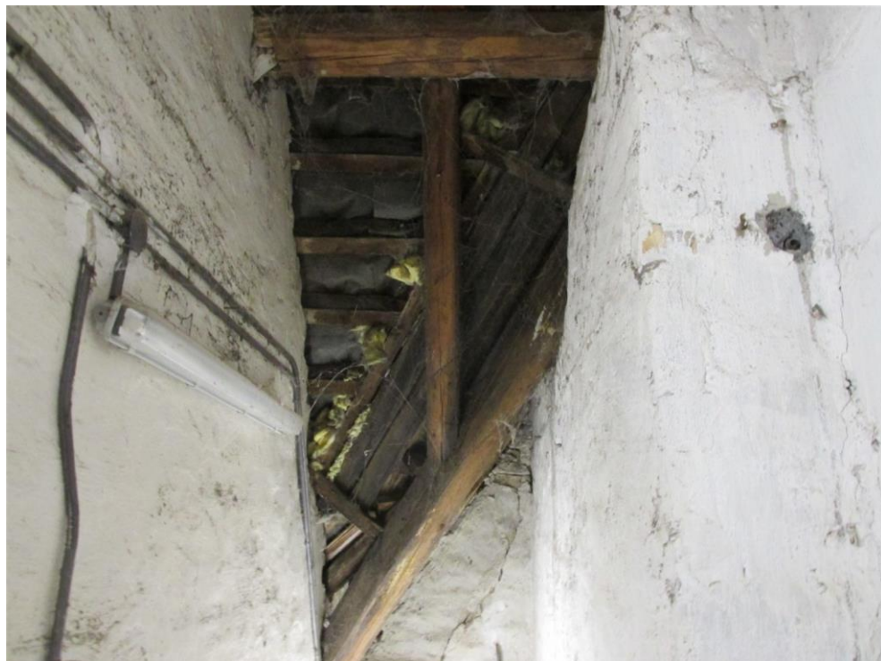
Kehlbereiche zum Anbaudach Alt beim Treppenaufgang Raum DG 05a. Hölzer zeigen Wasserspuren durch Feuchteintritt. Dadurch in Teilen Moderfäule als sekundärer Befall Insektenschäden und Schimmelpilze.
