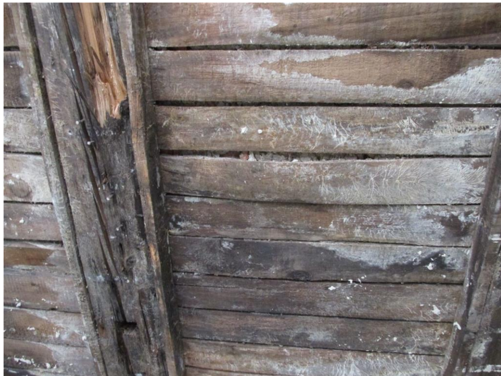
Detail Gauben Decke mit Myzeldurchwachsungen und zerstörten Balken.
