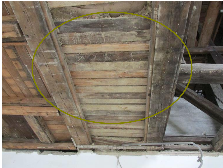
Im Einschub Myzelstränge des weißen Porenschwammes. Bei Balken 10 und 11. Einschub ausbauen und Balken prüfen.
