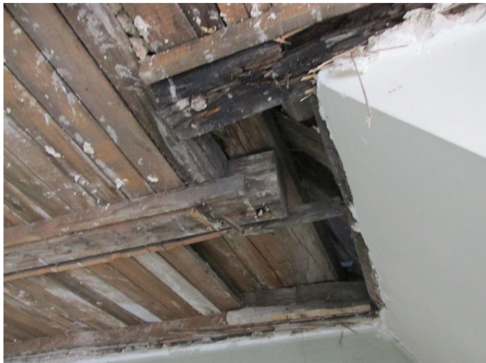
Detail: Gaubenanschluss an Hauptdach mit starker Braunfäule.
