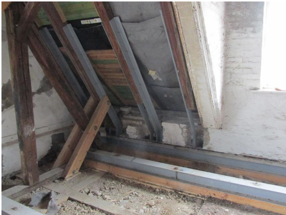
Bereich einer früher erfolgten Sanierung der Balkenlage.
