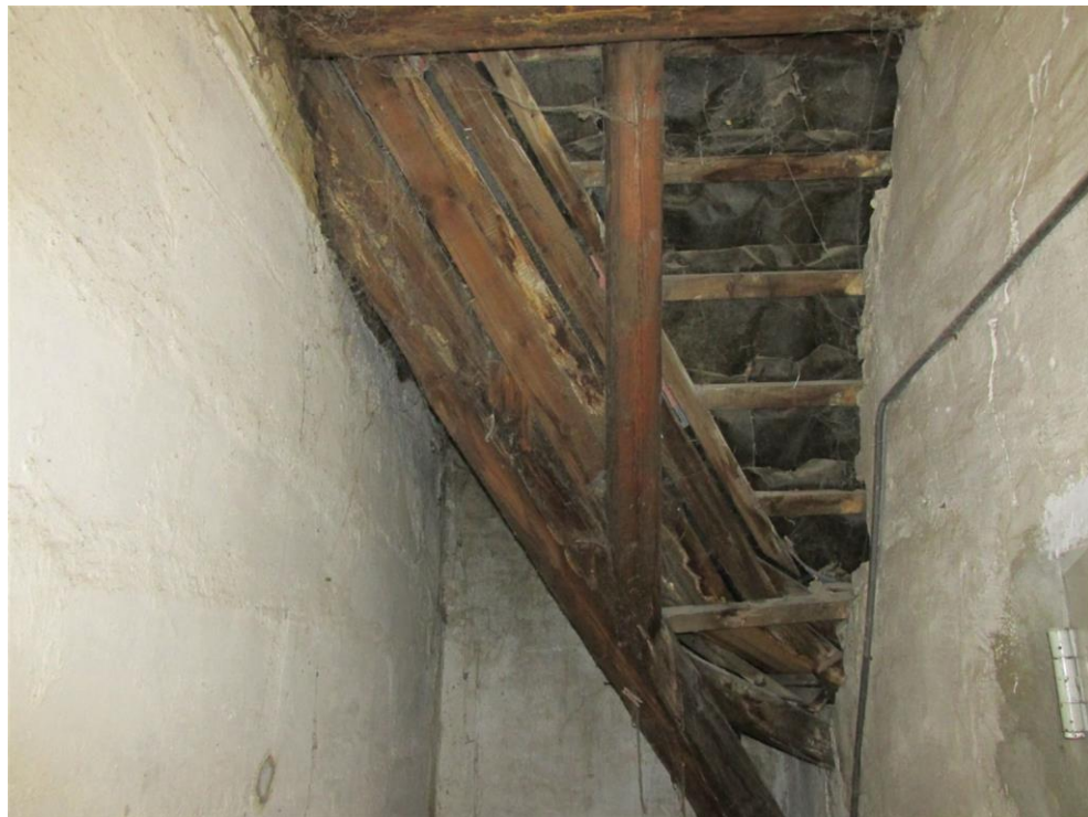
Kehle Raum DG 05a Nord-Ostseite. Wie vor behandeln.
