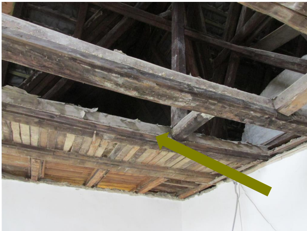
Balken 9, Sehr großer Durchhang, Holz mit Braunfäule, weich. Einschätzung: abgängig.
