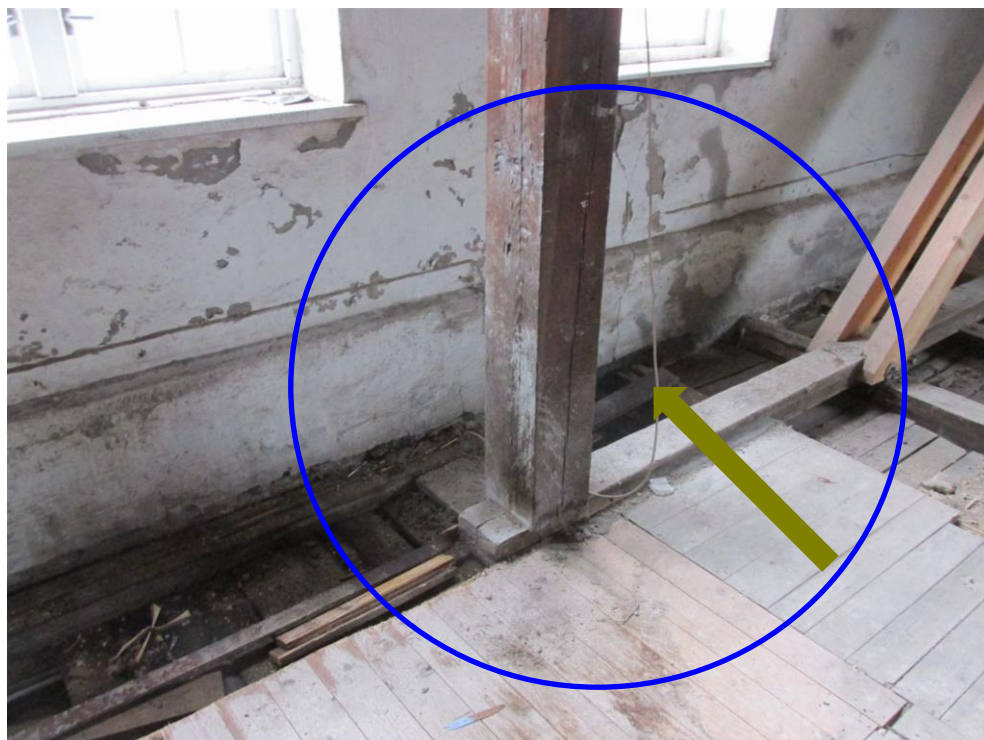
Altbefall Echter Hausschwamm. Keine konsequente Sanierung erfolgt: (roter Pfeil)
