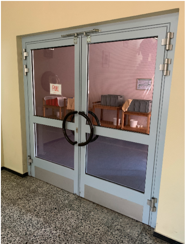
Bestandfoto: Tür in den Fluren/ Fluchtwegen
